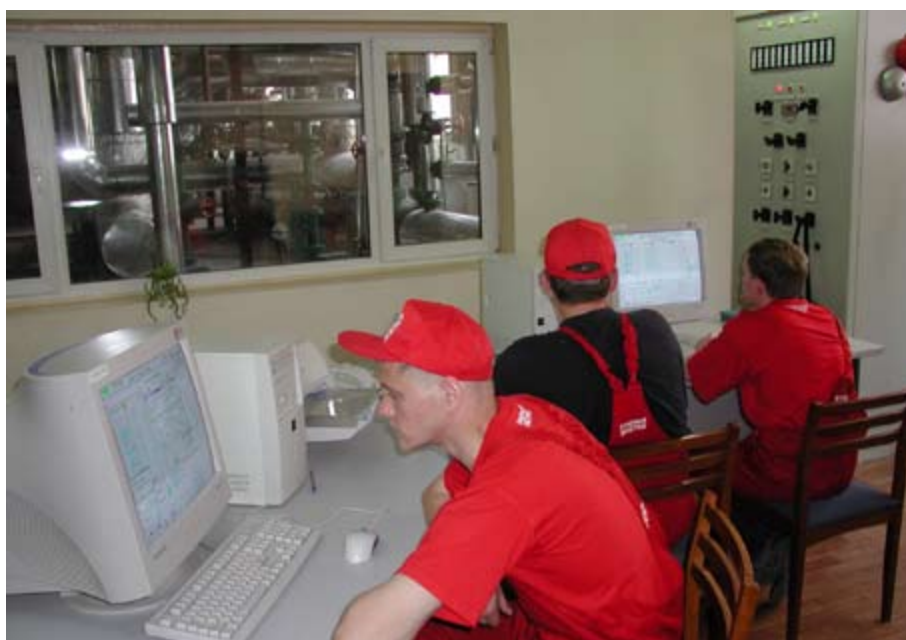
АРМ операторов котельной на базе InTouch
