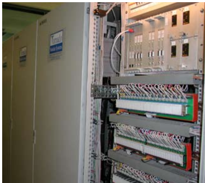
Шкафы контроллеров ПТК «Торнадо»
