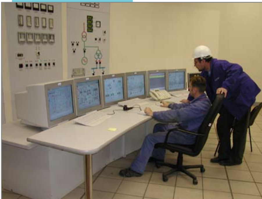
Автоматизированное рабочее место операторов на базе InTouch
