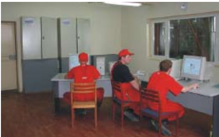
Автоматизированные рабочие места оператора и инженера котельной, шкафы контроллеров
